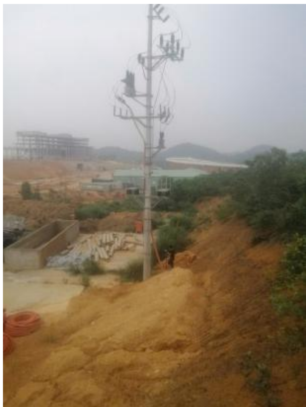
CỘT ĐƯỜNG DÂY CÁP ĐIỆN SÂN GOLF
