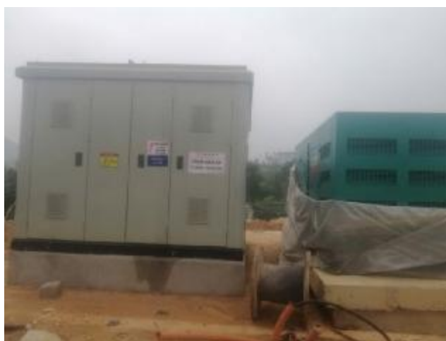
TRẠM ĐIỆN VÀ CHIẾU SÁNG SAN GOLF
